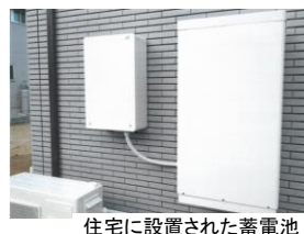
住宅に設置された蓄電池
