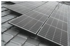
住宅の屋根に設置された太陽光パネル
