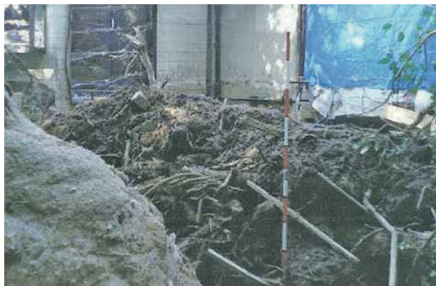
土砂流出による被害箇所（高松市）
