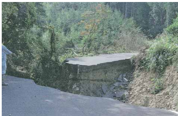
土砂流出による被害箇所（三豊市）
