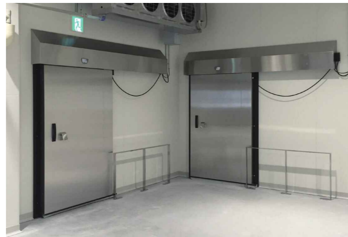
豊洲市場に導入された防熱扉
