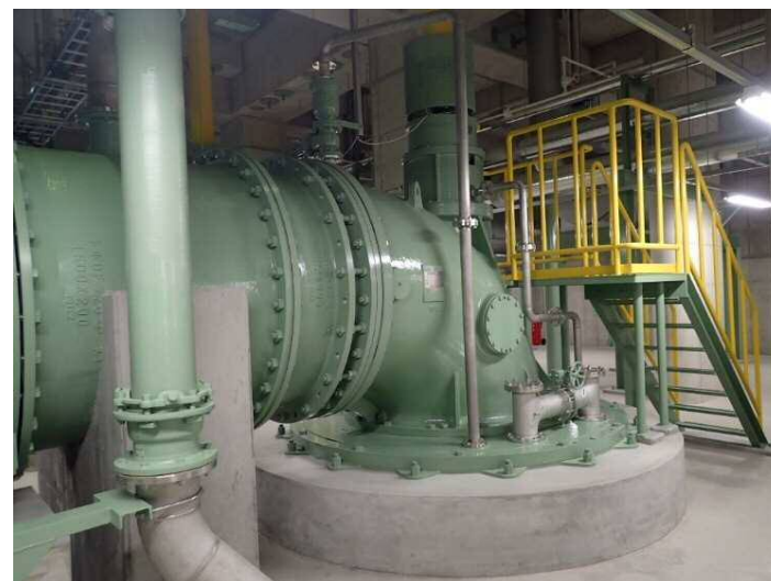
福岡ポンプ場雨水排水ポンプ(高段No.3)
