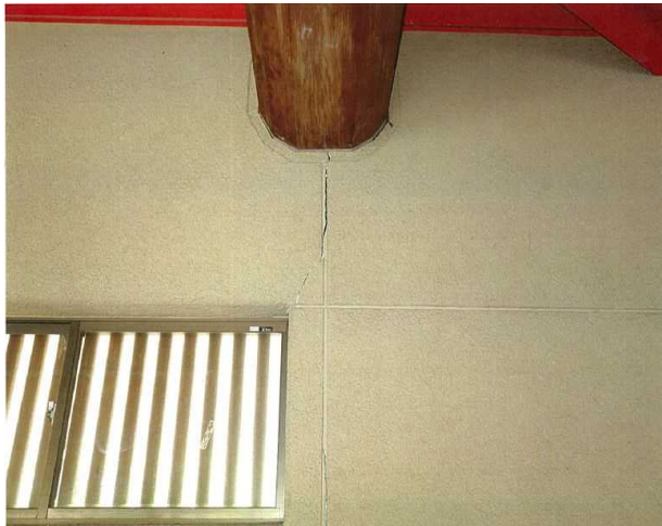
【整備前】壁面の亀裂
