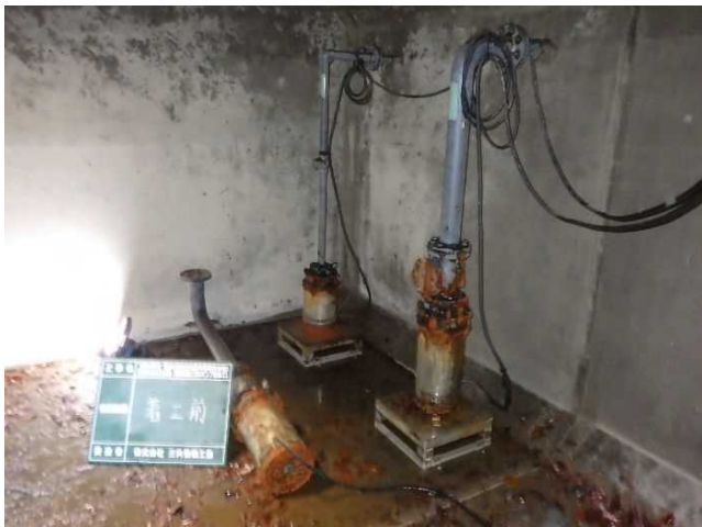
【整備前】ポンプ設備の劣化・故障
