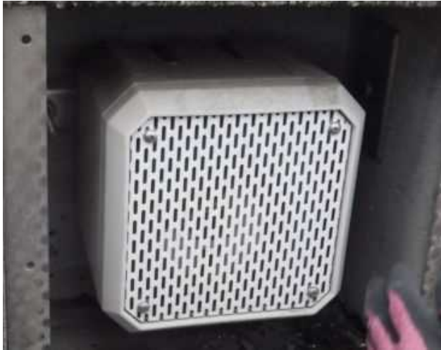
【整備前】非常用放送設備(スピーカー)の故障
