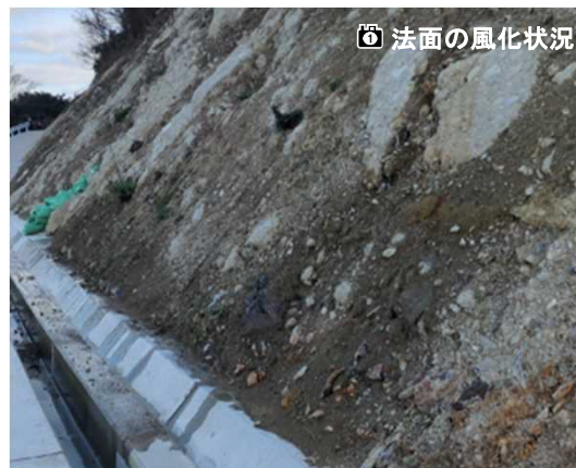
法面の風化による表層の部分的な滑落の恐れが確認された
