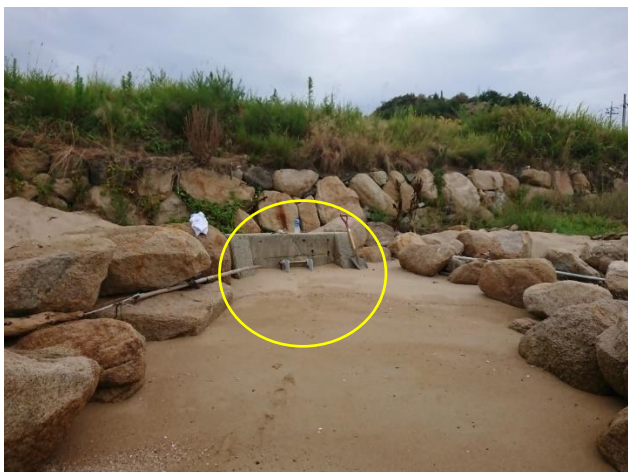
写真7 導水管出口の堆砂状況
