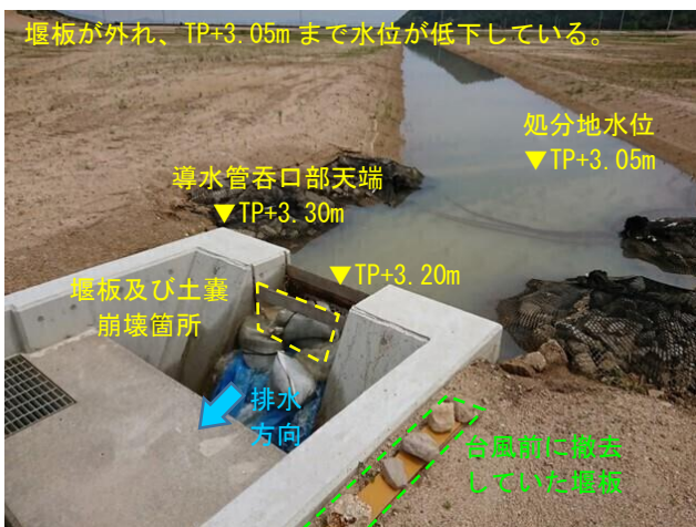
写真1 導水管呑口部の状況 （令和5年6月5日）
