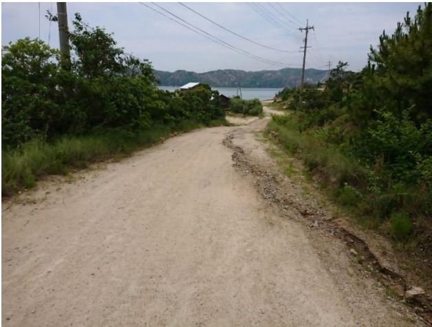
写真3 坂路の洗堀状況 (令和5年6月5日)
