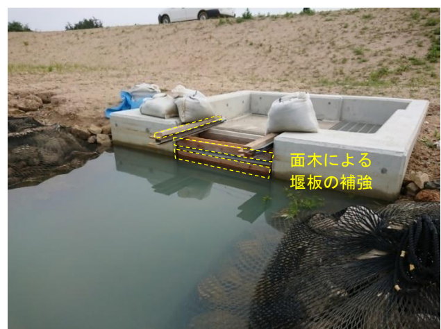
写真2 導水管呑口部の状況 （令和5年6月13日）
