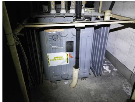
(4) 高圧トランス
