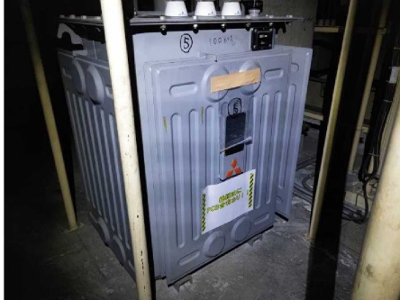
(1) 高圧トランス
