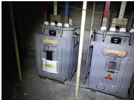
(3) 高圧トランス
