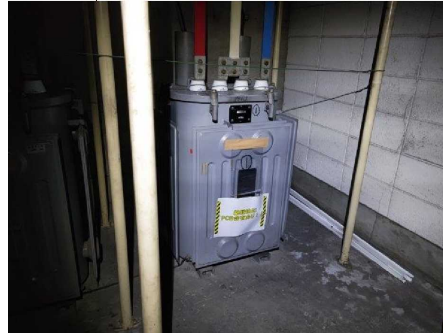
(2) 高圧トランス
