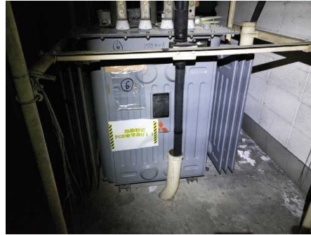
(4) 高圧トランス
