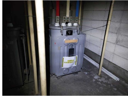
(2) 高圧トランス
