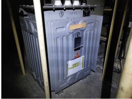
(1) 高圧トランス
