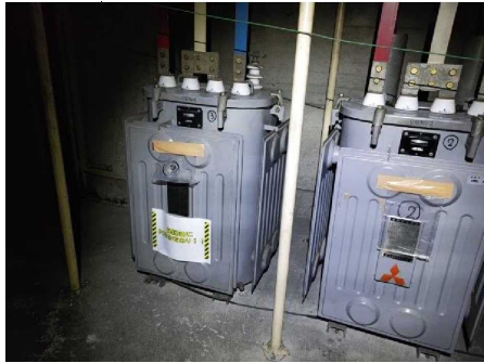
(3) 高圧トランス
