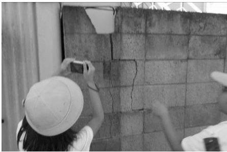
【危険箇所を写真に記録】
