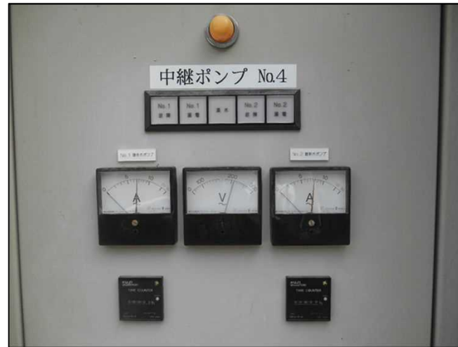
マンホールポンプ 制御盤
