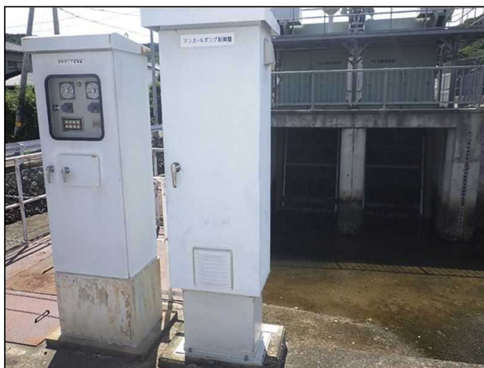
マンホールポンプ 制御盤
