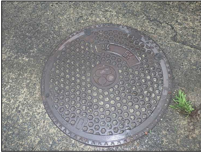
マンホールポンプ人孔 蓋
