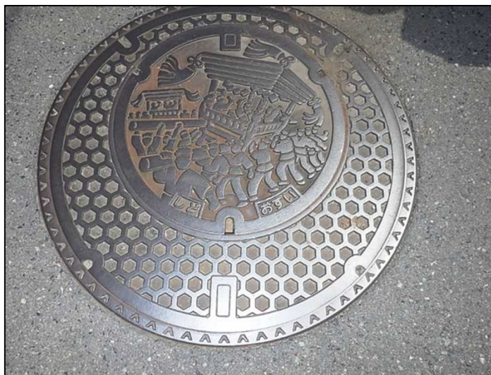
マンホールポンプ人孔 蓋
