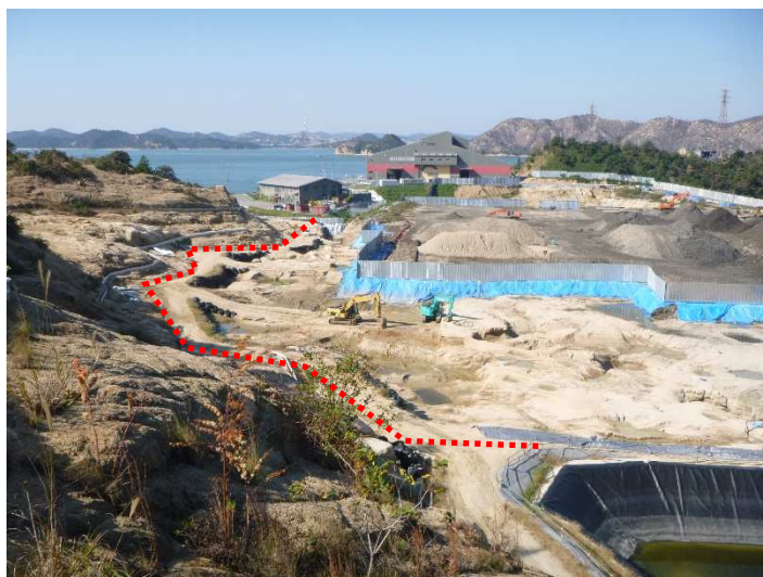
写真3 送水管(H26設置時)
