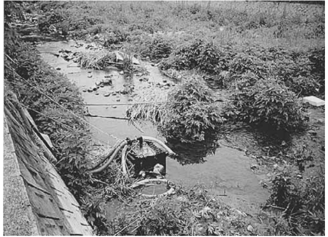
写真2 流入河水(柞田川)ポンプ設置部
