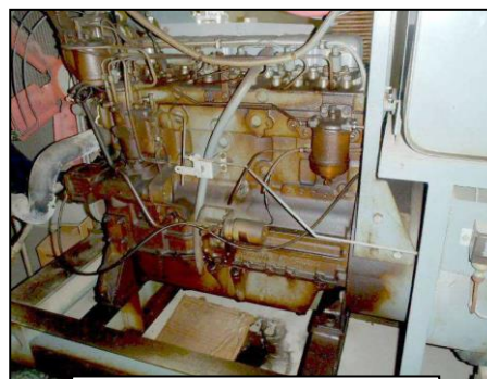
発電設備の錆、油漏れ
