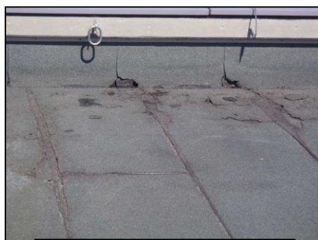
屋上防水層の浮き・剥がれ
