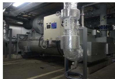
ターボ冷凍機
