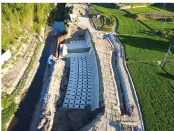
工事名 : 本津川大規模特定河川工事 (佐久間井堰下部工) 委託者 : 高松土木事務所 場所 : 高松市 鬼無町
