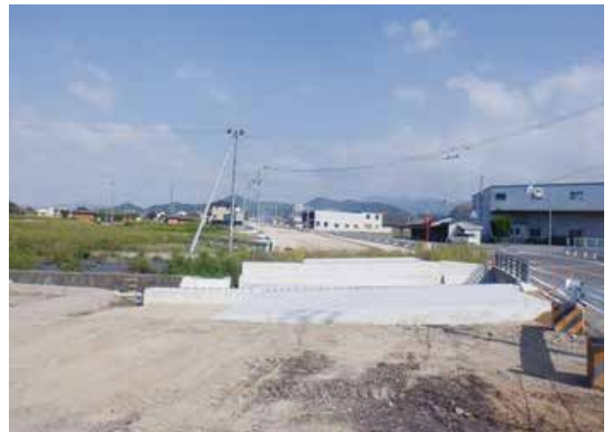
工事名 : (防災・安全社会資本整備交付金)県道丸井萩原豊浜線 (大野原工区)交通安全施設整備工事(橋梁下部工) 委託者 : 西讃土木事務所 場所 : 観音寺市 大野原町 大野原
