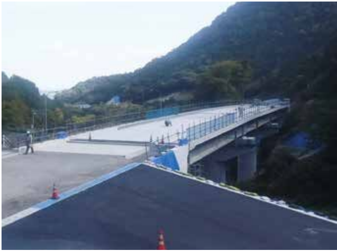
工事名 : 県道高松坂出線(五色台工区) 道路改築工事 (第3工区)(亀水橋上部工) 委託者 : 高松土木事務所 場 所 : 高松市 生島町他
