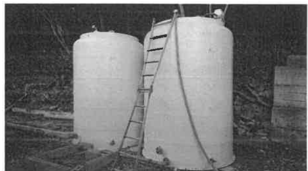
オリーブ採油粕の脱水液の貯蔵タンク
