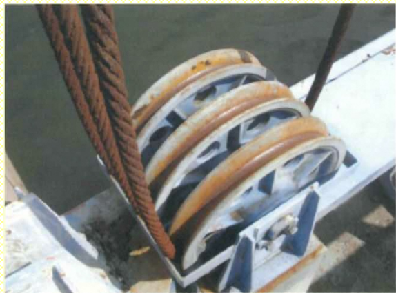
ワイヤーシーブの塗装劣化 及び油脂類不足
