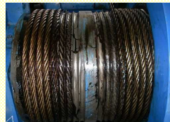
ワイヤーロープのゆがみ 8 及び油脂類不足
