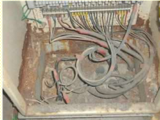
配線類の経年劣化
