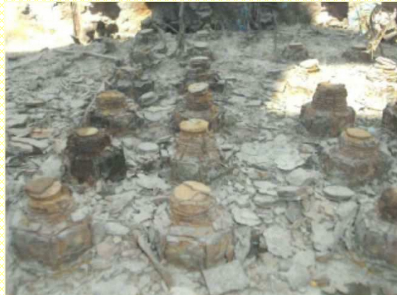
鋼材の著しい腐食
