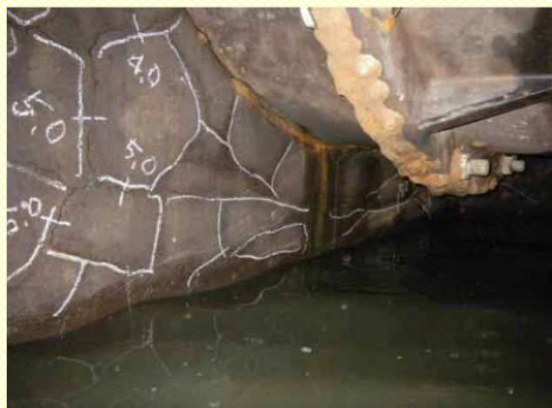
排水機場本体(水槽)
