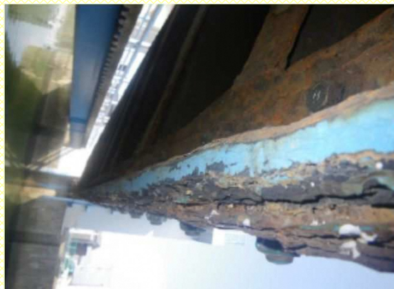
水密ゴムの劣化
