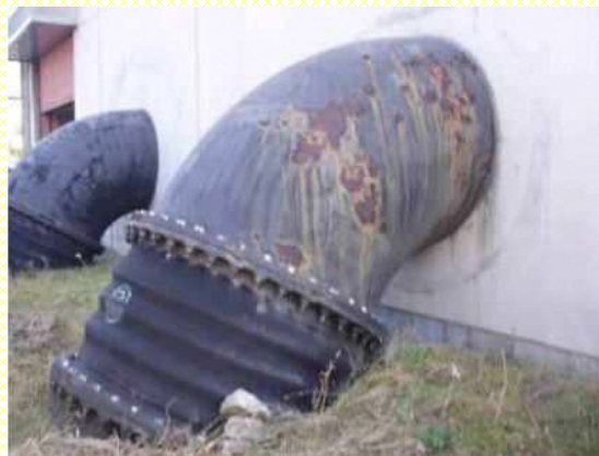
ポンプの被覆塗装の劣化
