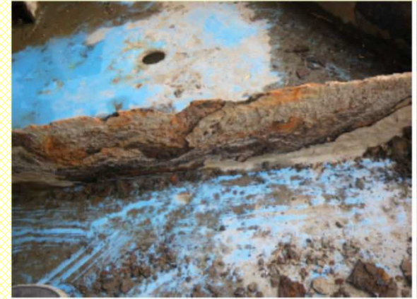
横桁の著しい腐食
