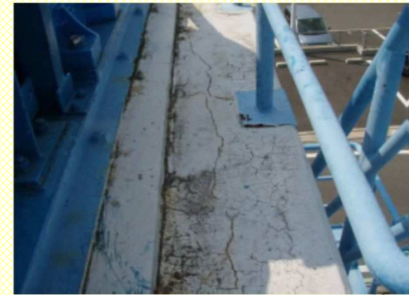
開閉装置架設台
