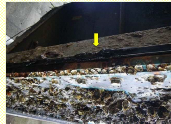
水密ゴムの破損
