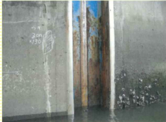
塗装劣化及び発錆
