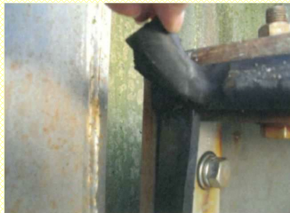
水密ゴムの破損
