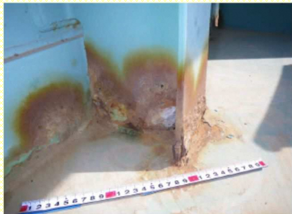
桁接合部の腐食
