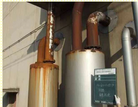
排気管の著しい腐食
