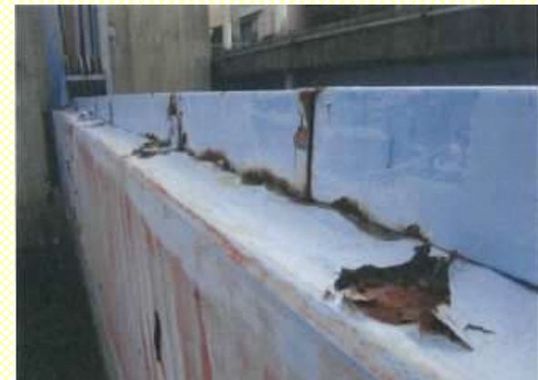
塗装の割れ、剥がれ
