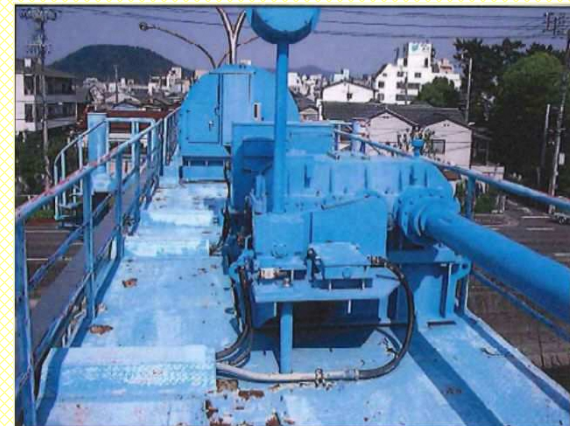
操作台の鋼材腐食
