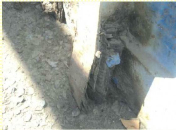
縦桁の著しい腐食
