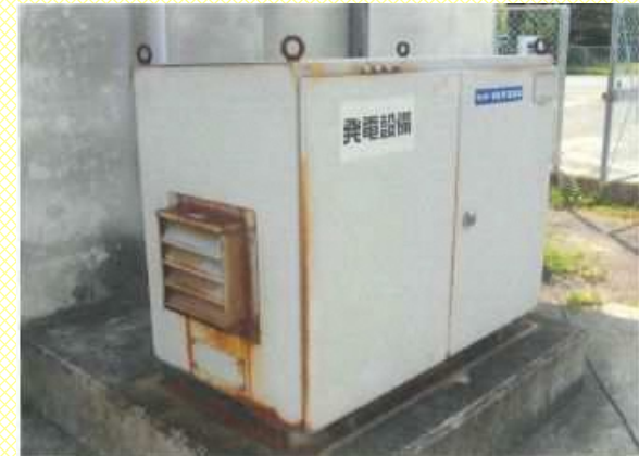
発電機の経年劣化
