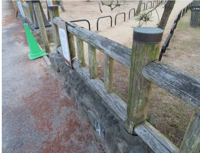
【整備前】 木柵腐食状況
