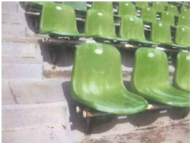
【整備前】 観客席床面塗装の劣化
