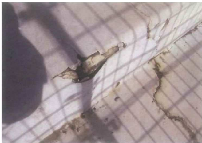
【整備前】 観客席床面塗装の劣化
