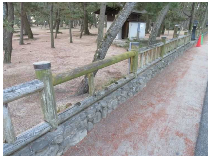
【整備前】 木柵腐食状況
