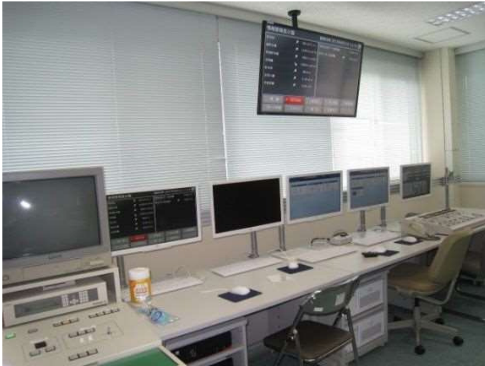
ダム管理用制御処理設備の改良など
