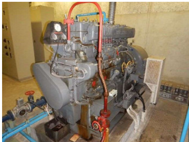
発動発電機更新前
