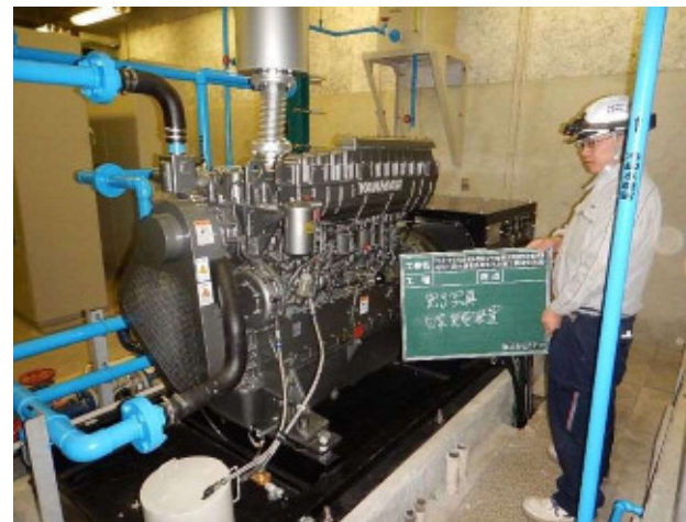
発動発電機更新後
