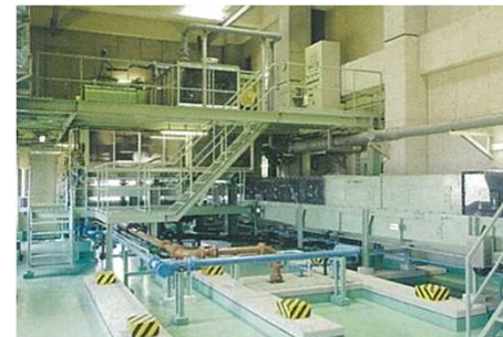
汚泥脱水施設
