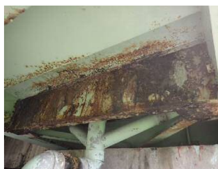
【横桁（階段部）の腐食】
