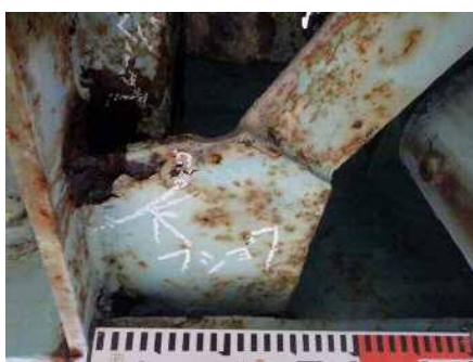
【主桁端部の腐食】
