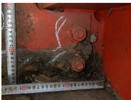
【鋼橋（主桁端部の腐食）】
