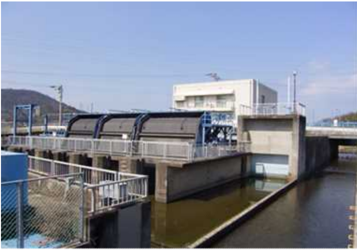
坂出市 川津都市下水路 川津ポンプ場
