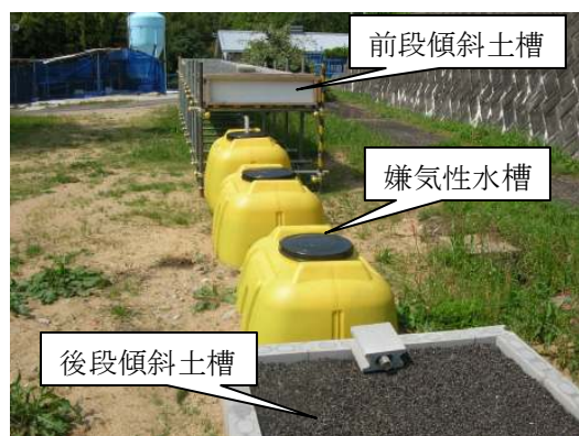
図1 傾斜土槽法による水質浄化装置
