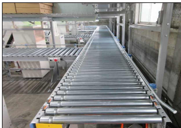
搬送コンベア
