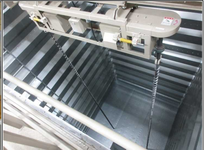
貯蔵乾燥設備
