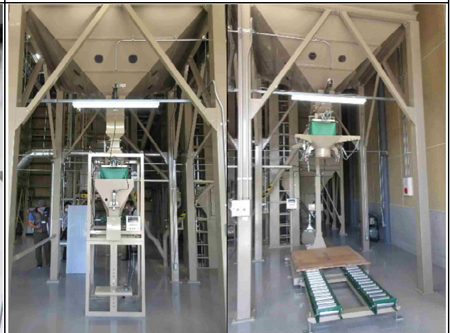
⑥ 計量出荷設備
