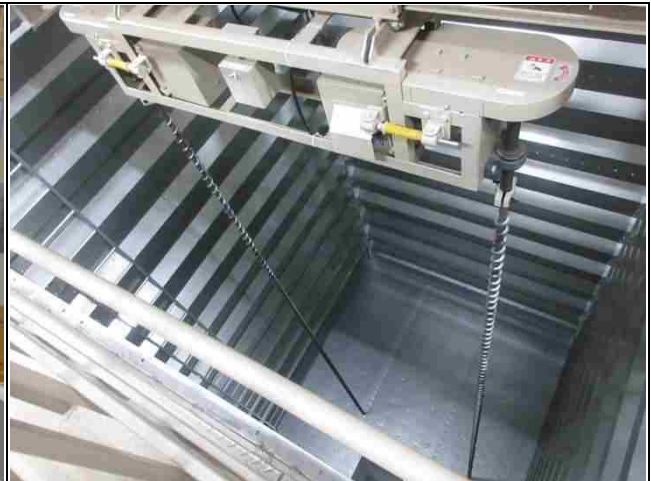
② 貯蔵乾燥設備
