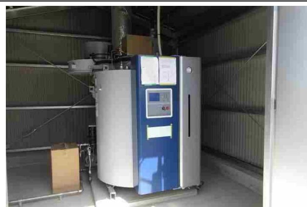
④ ボイラー
