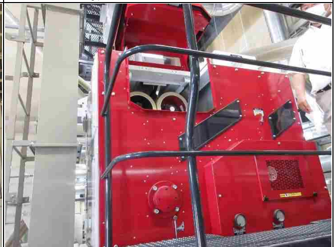
④ 粃摺調製設備 (粃摺り)
