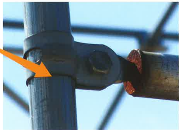
筋かい補強の妻側パイプとの接合部 (この部分が劣化しやすい)
