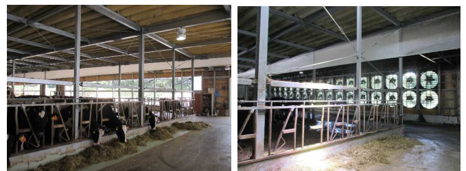
トンネル換気方式の牛舎
