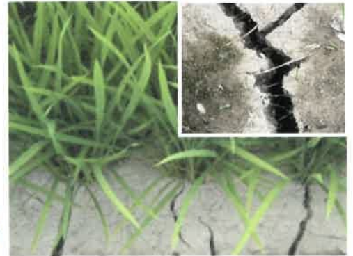
ひび割れは1cm以内に
