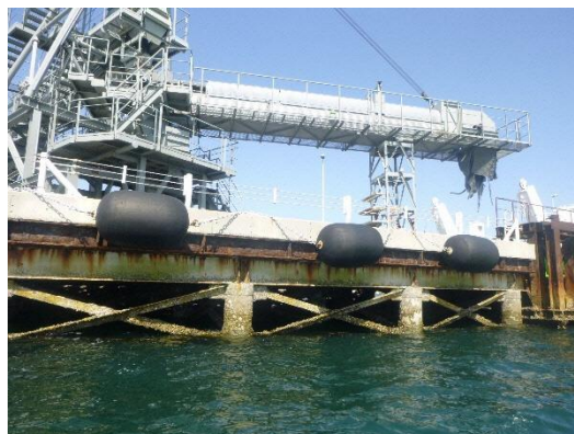
写真2 ベルトコンベア（海側）
