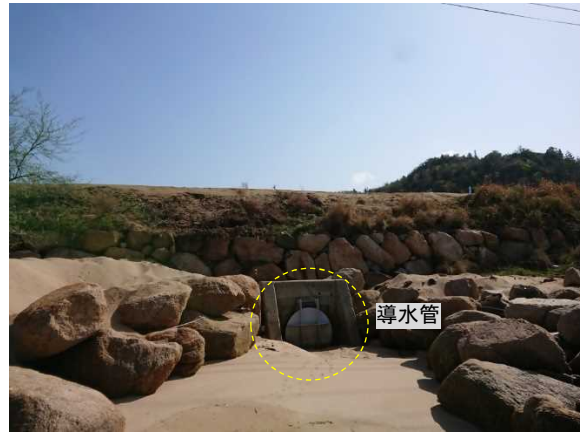
写真区-12 ⑥-4-3 導水管
