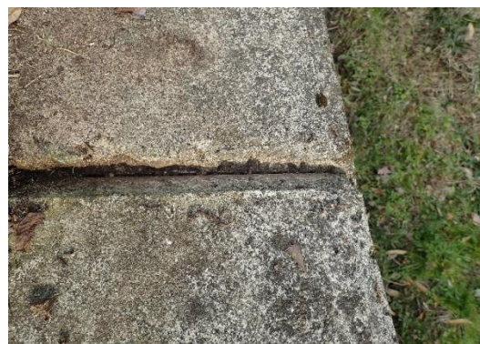
写真2 H16-02 側壁 (既往調査時)
