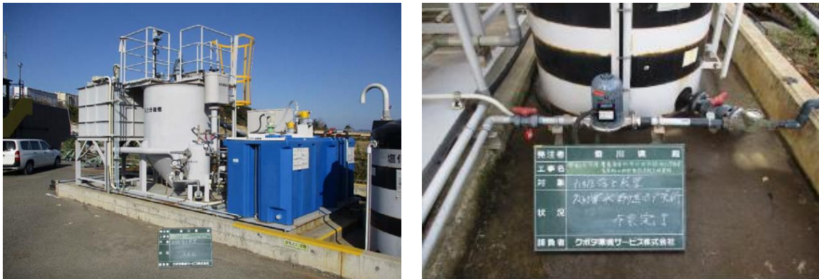
写真 19 加圧浮上装置 整備完了
