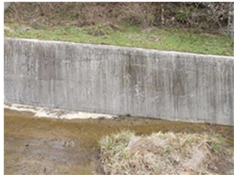
写真2 H16-02 側壁 (既往調査時)
