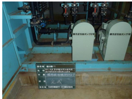
写真9 膜汚泥引抜ポンプ 整備完成
