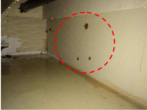
写真 12 No.1 膜浸漬槽 錆の発生 (セラミック膜モジュール下部)
