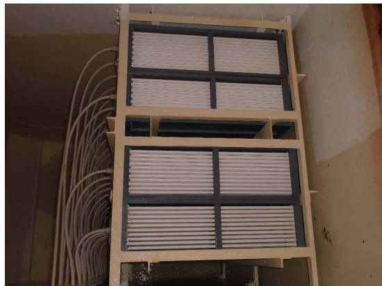
写真11 セラ膜 No.2(薬品洗浄後)
