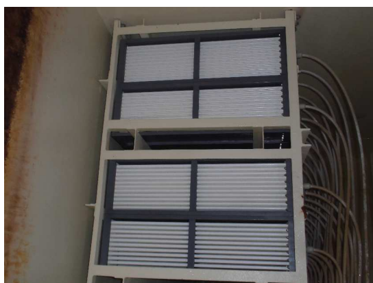
写真10 セラ膜 No.1(薬品洗浄後)
