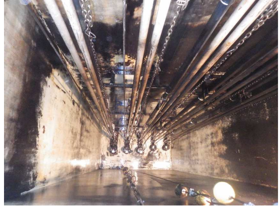
写真 3 膜ろ過処理水槽 清掃後
