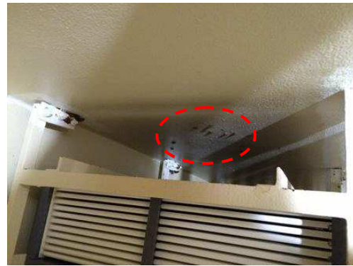
写真 15 No.2 膜浸漬槽 錆の発生 (セラミック膜モジュール横)
