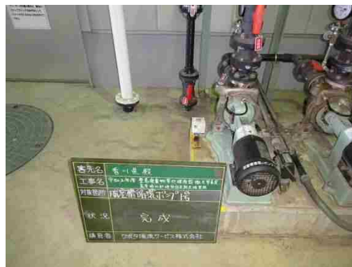
写真5 脱窒槽循環ポンプ 整備完了
