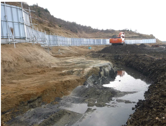
写真6 H測線付近の廃棄物からの浸出水
