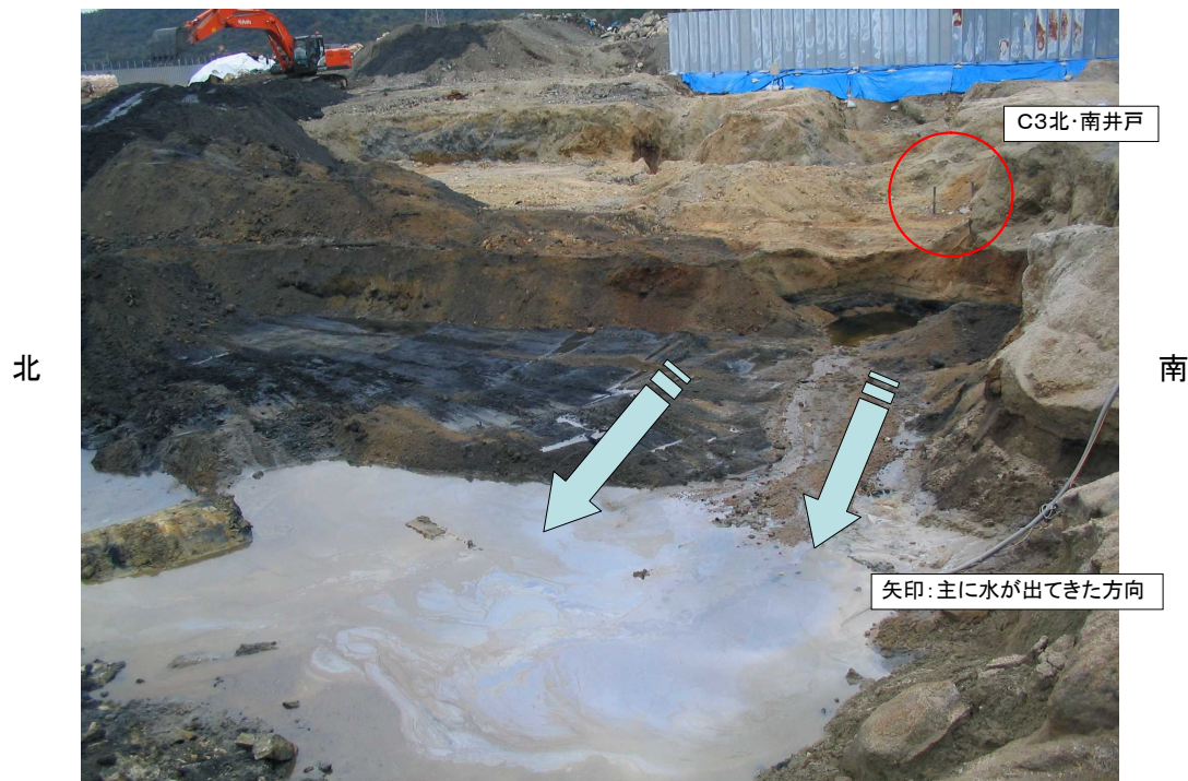
写真1 溜まり水の発生の様子（H25.11.27撮影）
