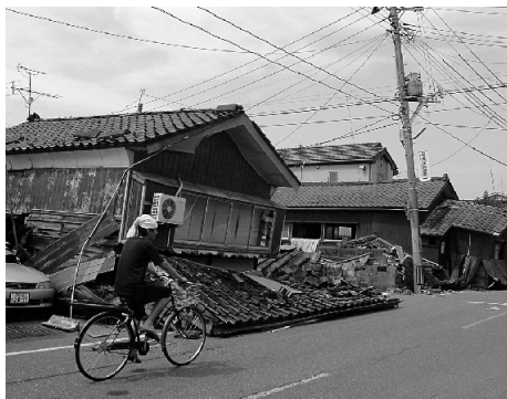
今年7月16日に発生した新潟県中越沖地震。柏崎市内では1階部分が崩れ落ちた民家が目立った。同日18日、西嶋正法撮影
