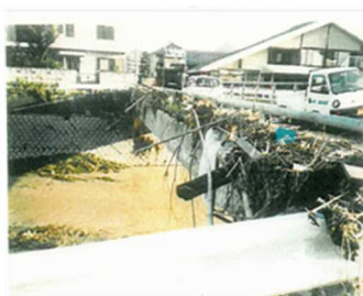
万灯橋高欄の流木等の痕跡
