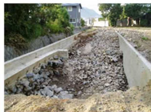
野間川越水により右岸堤防 の洗堀
